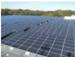
エルナー白河太陽光発電所
