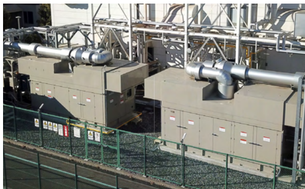
コージェネレーションシステム
