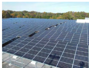
エルナー白河太陽光発電所
