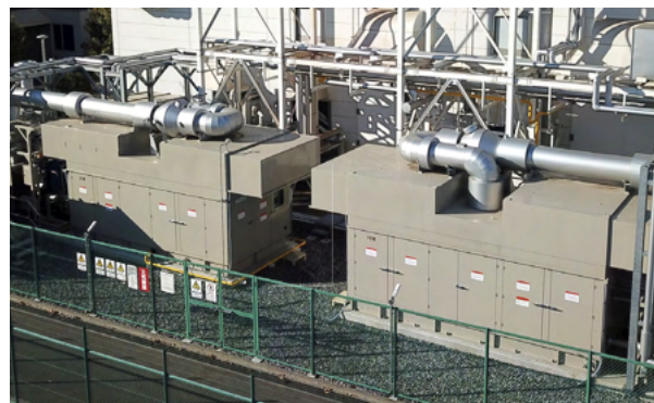
コージェネレーションシステム
