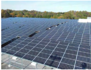
エルナー白河太陽光発電所
