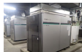
コンプレッサー
